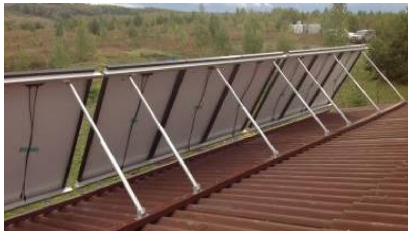
Рисунок 4.8 – Приклад встановлення сонячних батарей
