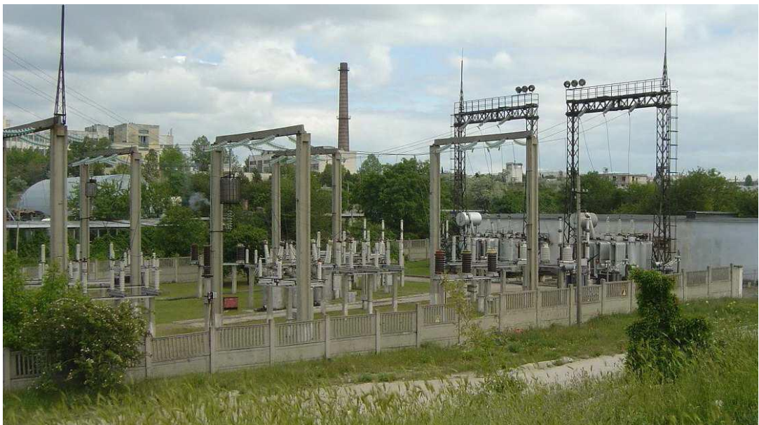
Рисунок 1.4 – Районна підстанція 110/10 кВ
