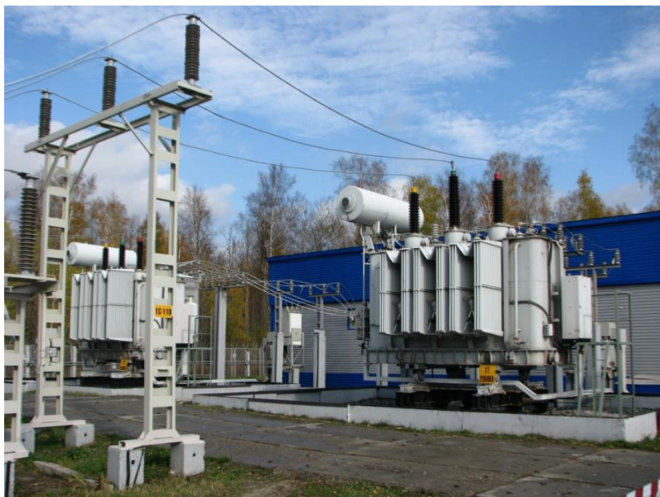
Рисунок 1.6 – Понижувальна споживча трансформаторна підстанція 10/0,4 кВ
