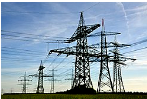
Рисунок 6.5 – Ґратчаста металева опора
