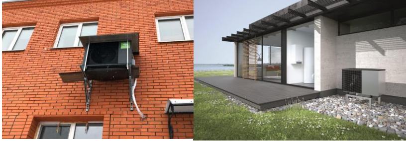
Рисунок 5.8 – Приклади установки теплових насосів
