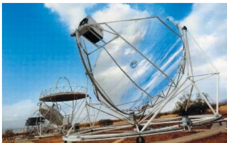
Рисунок 4.25 – Сонячна установка тарілкового типу: а – схема сонячної установки тарілкового типу; б – сонячна установка потужністю 10 кВт на сонячній електростанції в Almeria (Іспанія)
