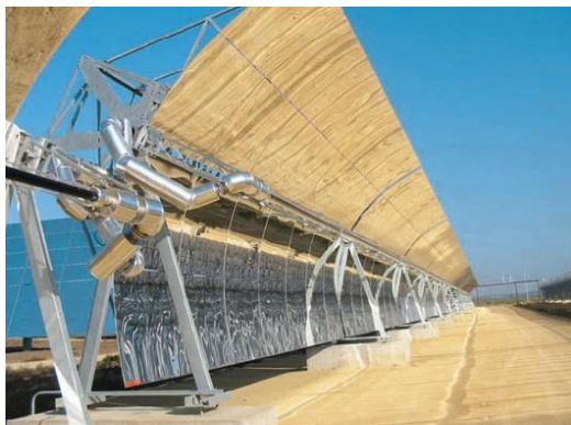
Рисунок 4.24 – Довгі параболічні (в поперечному перерізі) дзеркала з трубами для розігрівання теплоносія (фото «Solucar»)
